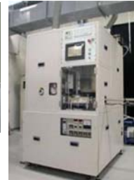
エッチング装置 (共有施設)
